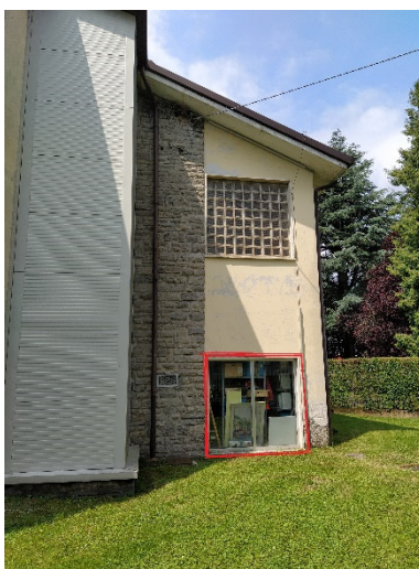
Serramento 210x195 c/o vano scale piano seminterrato
