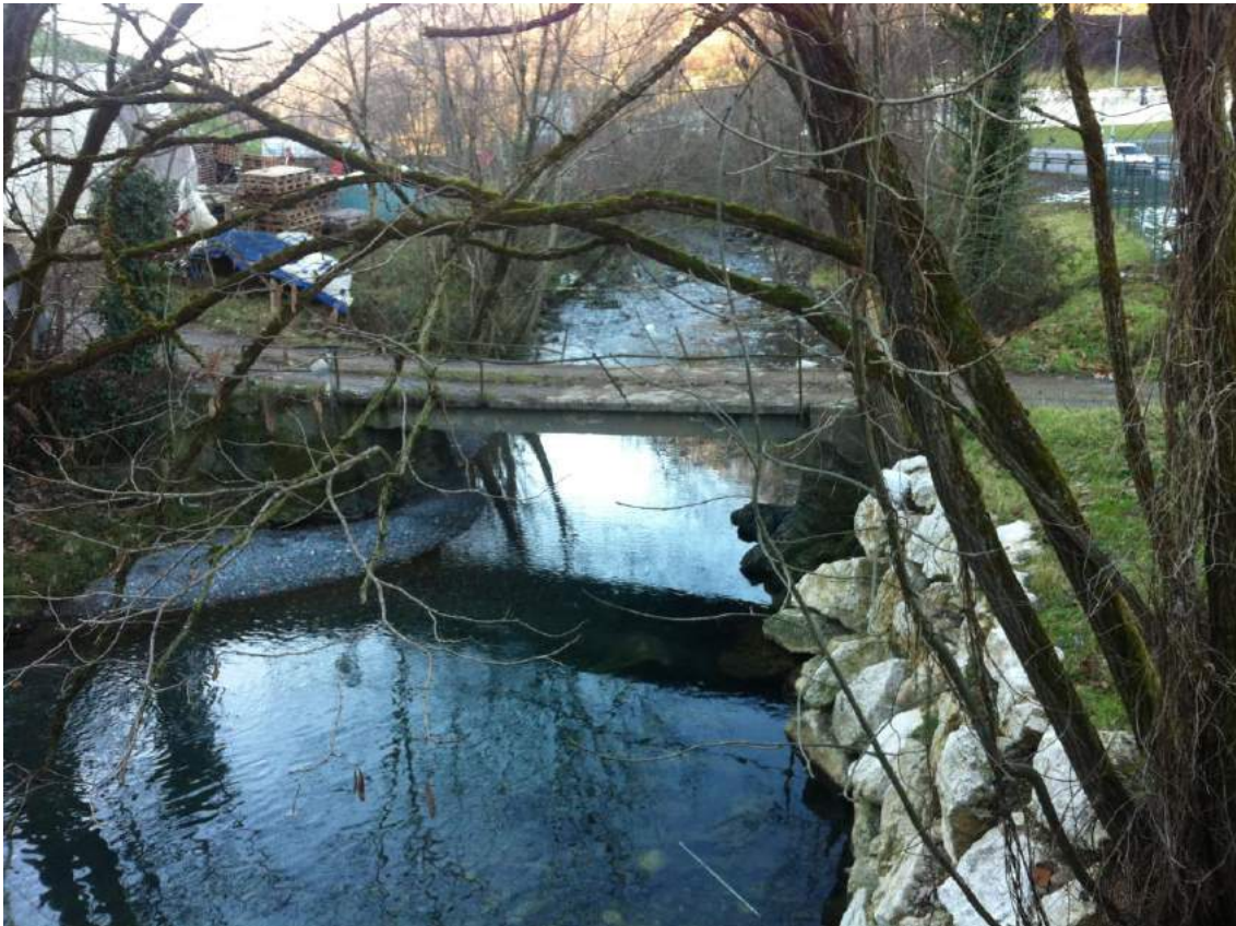
Fig. 10 - Attraversamento carrale in corrispondenza del Torrente Romna, loc. Melgarolo (vista da valle)
