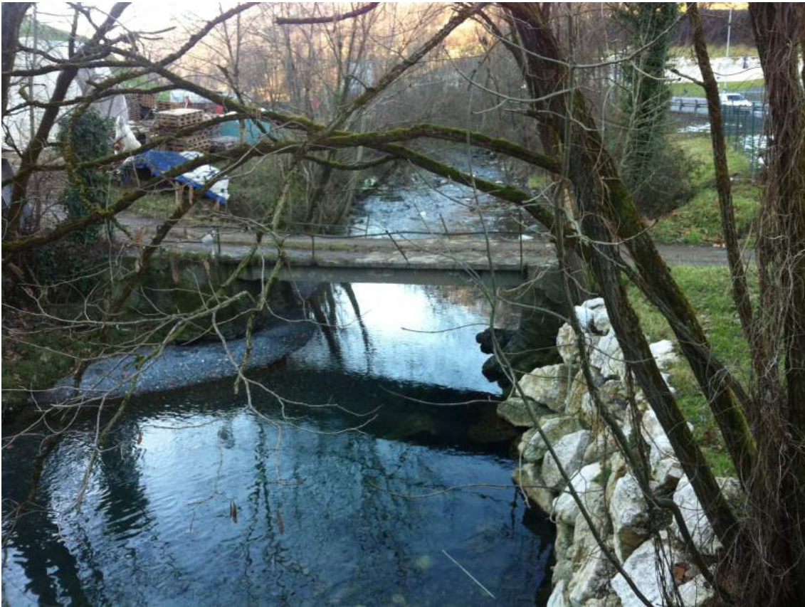
Fig. 26 - Attraversamento carrale in corrispondenza del Torrente Romna, loc. Melgarolo (vista da valle)
