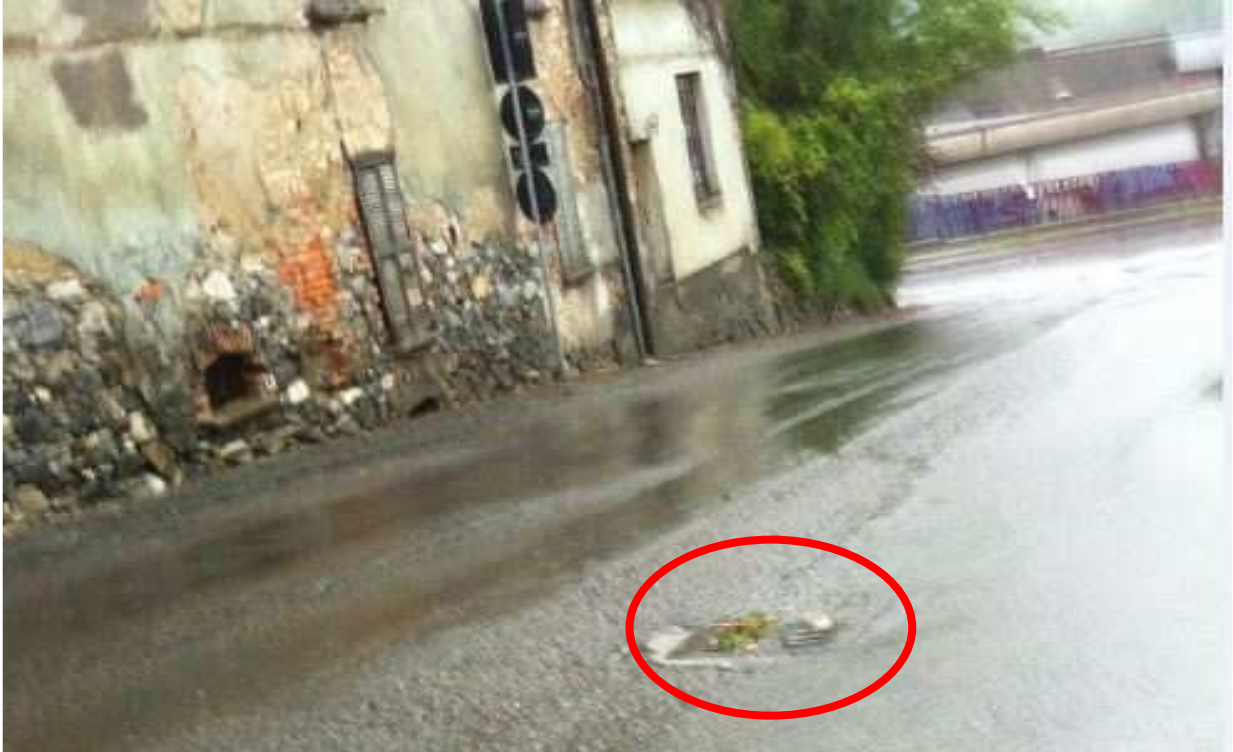
Fig. 30 – ruscellamenti lungo la strada che da via Manzoni di Gandino conduce verso Leffe e fuoriuscita degli apporti fognari dalle caditoie in corrispondenza di eventi meteorici intensi di agosto 2016
